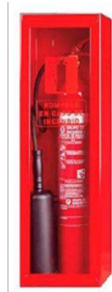
Figura 3.- Gabinete de extintor
